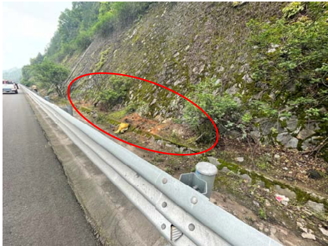
图 5 第一阶护面墙脚挤压开裂
